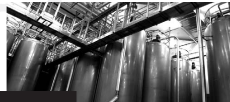
Blick ins Tanklager
